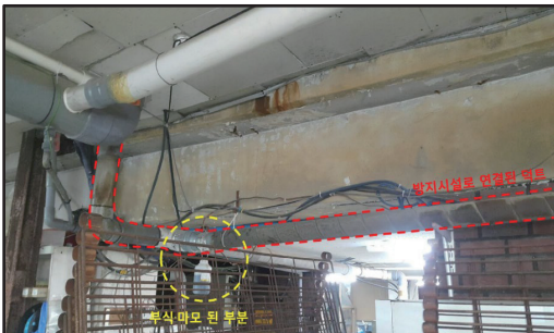
<건조시설(대기배출시설)에 연결된 관토에 통을 때냄>
