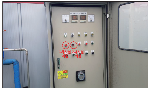
< 2차 방지시설이 미가동 상태로 불이 꺼져 있음을 확인 >
