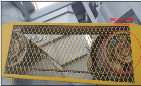
<방지시설 벨트가 가동 정지인 상태를 확인>
