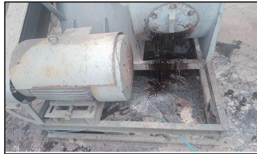
< 방지시설에 연결된 송풍기가 부식되어 오염물질이 나옴 >
