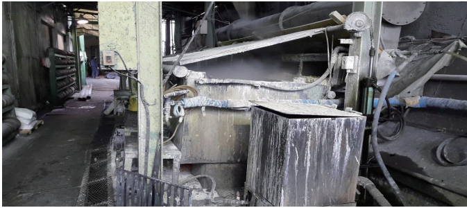
폐수배출시설 (알칼리처리시설) 전경
