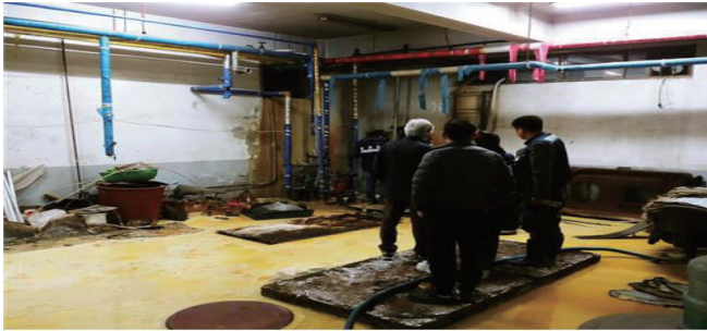
건물 지하바닥에 가득한 크롬(VI)폐수
