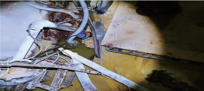
폐수 비밀배출을 위해 설치된 펌프
