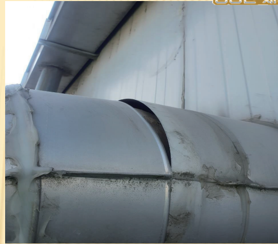
덕트 연결 부위 파손
