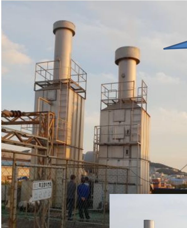
EFC 설치 전 스크러버
