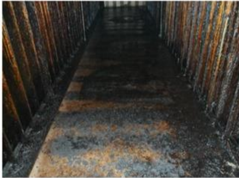
건식 혹은 세정 전처리 장치 없이 가동된 전기집진기 내부
