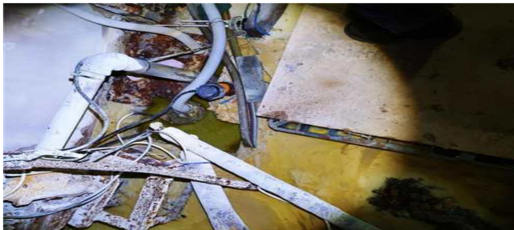
폐수 비밀배출을 위해 설치된 펌프
