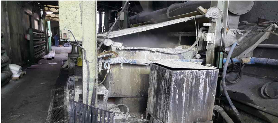
폐수배출시설 [알칼리처리시설] 전경
