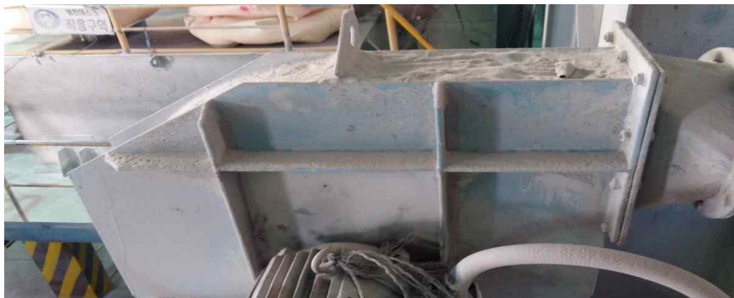
여과집진시설 모터 연결 부위로부터 나와 쌓인 오염물질
