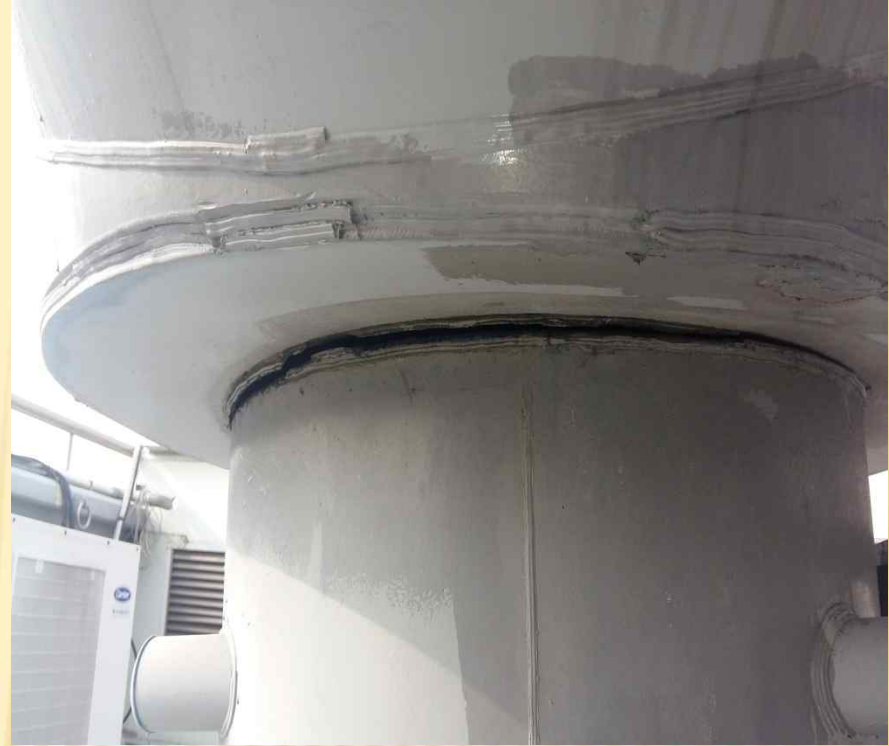
덕트 연결 부위 파손
