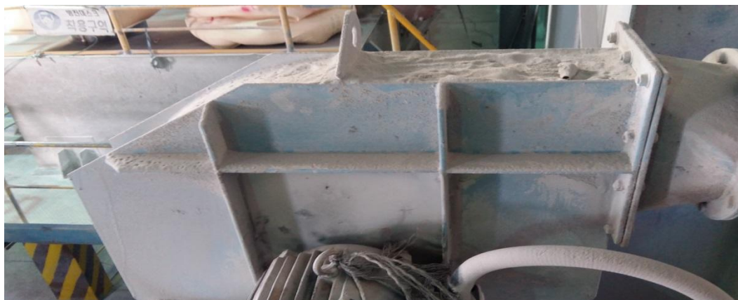
여과집진시설 모터 연결 부위로부터 나와 쌓인 오염물질
