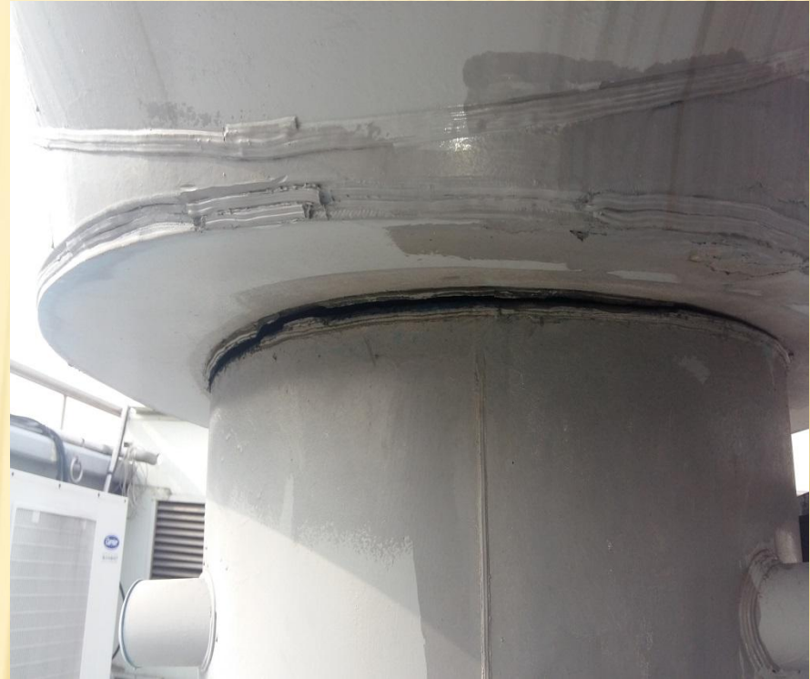
덕트 연결 부위 파손
