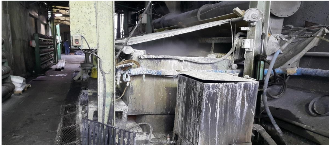
폐수배출시설 [알칼리처리시설] 전경
