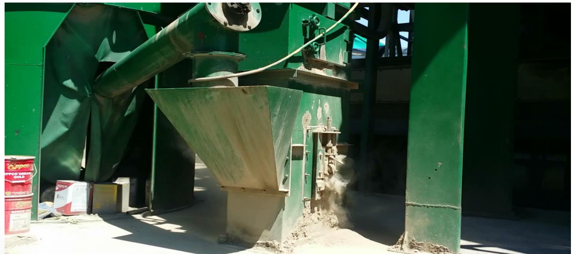
(부식 마모로 새나가는 배출시설 방치 - 아스콘업체)
