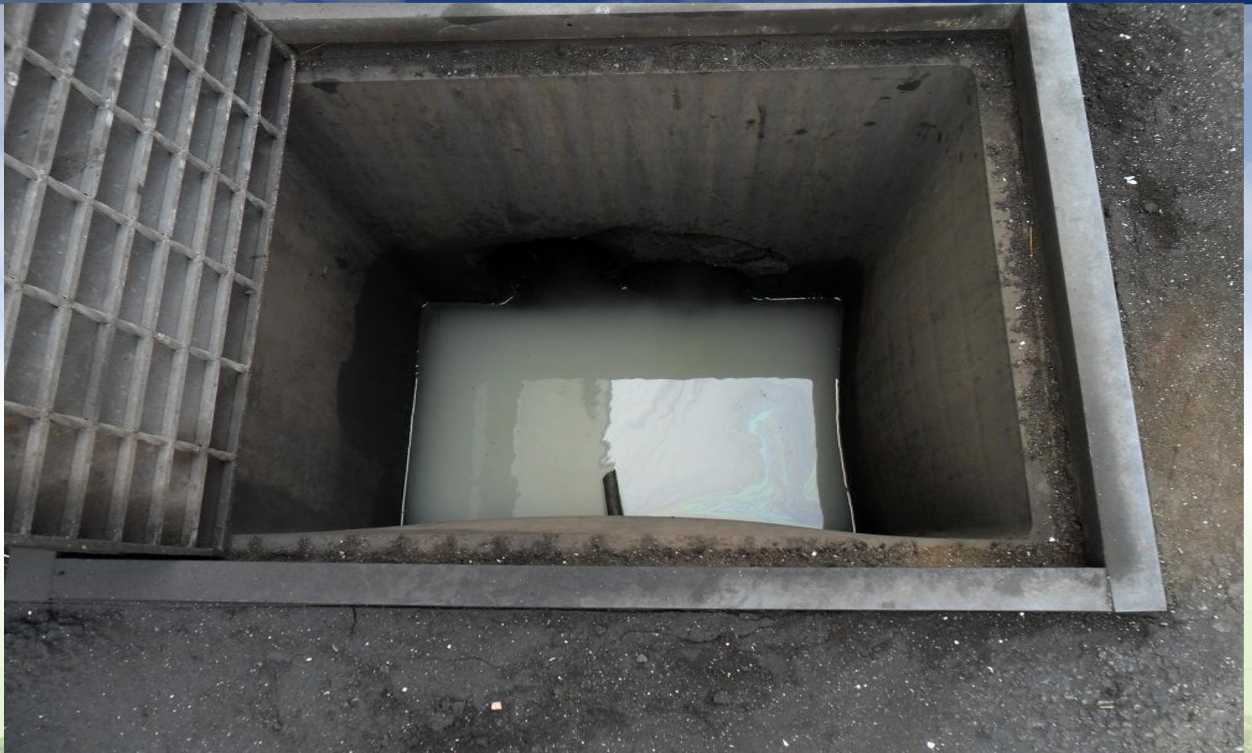
녹색기업 우수로 (절삭유로 인한 오염) 장면
