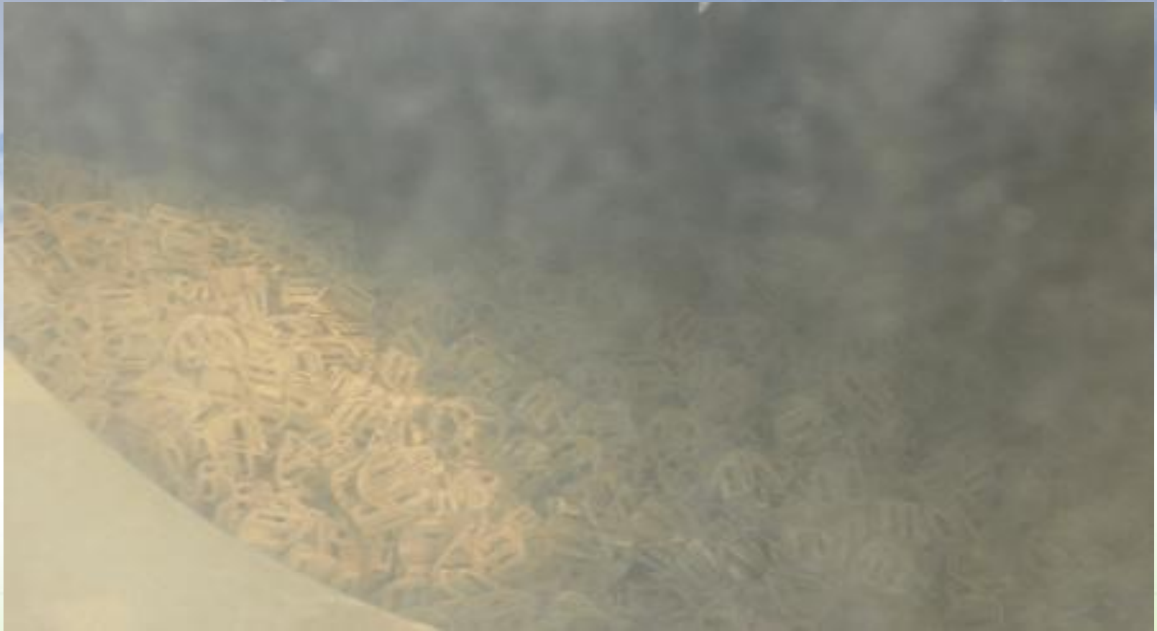
세정집진시설 내부 장면(세정수 미공급)
