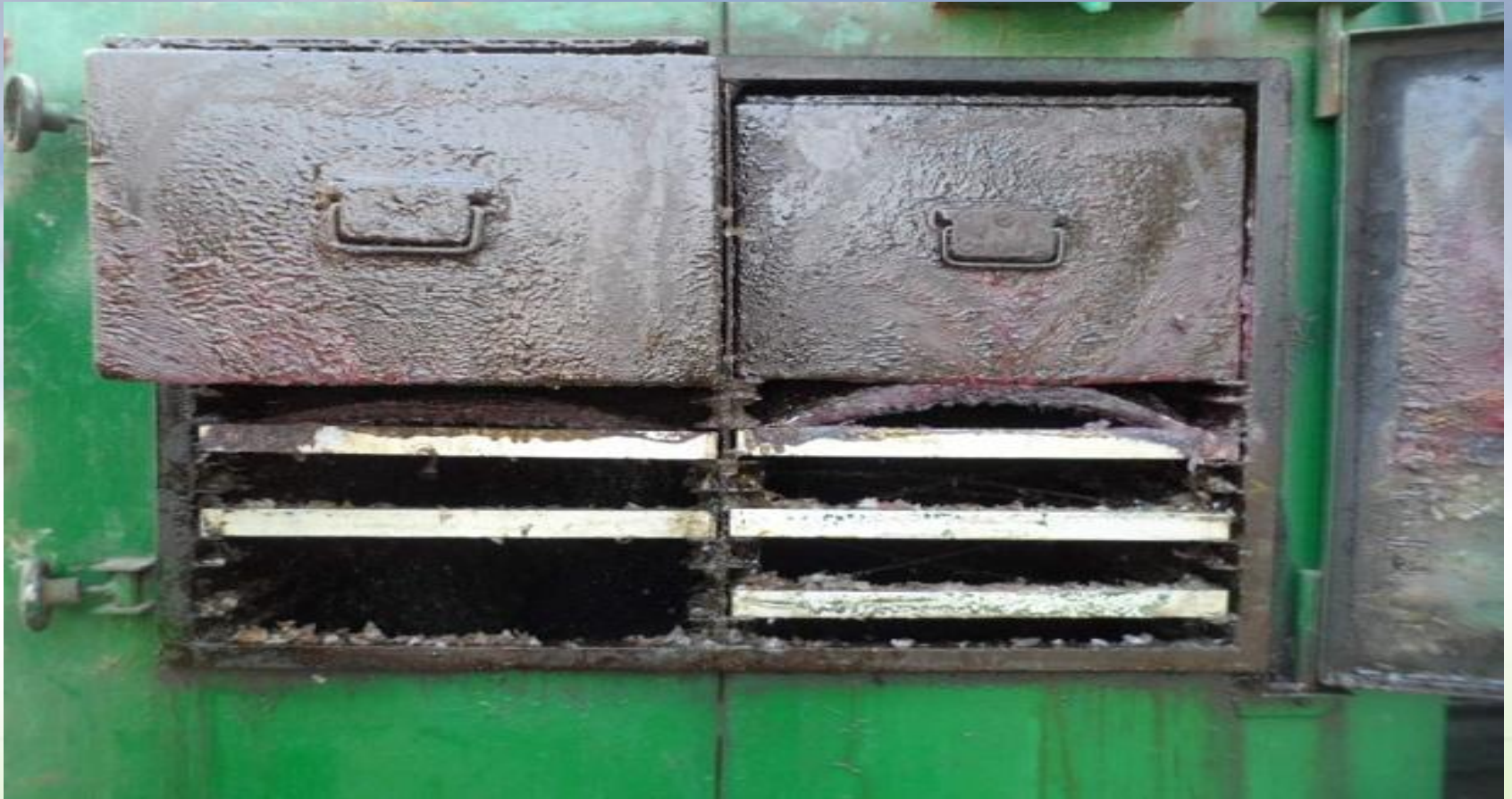
여과 집진시설 내부 장면(여과포 막힘, 일부 제거)
