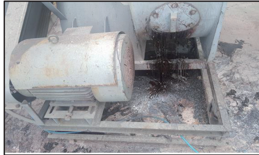
< 방지시설에 연결된 송풍기가 부식되어 오염물질이 나옴 >
