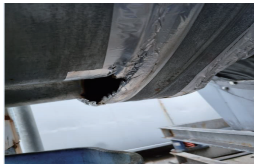
< 오염물질이 통과하는 관로가 훼손된 상태로 방지 >
