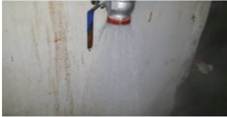
〈폐열회수로 발생한 응축수 배출 사진〉
