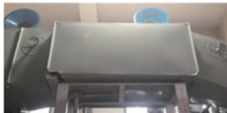
〈보일러 배기가스 열회수 설비 후(절탄기)〉
