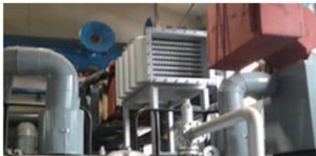
〈보일러 배기가스 열회수 설비 전(절탄기)〉
