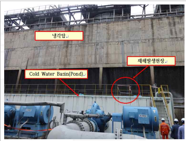
[사고발생 냉각탑 전경]
