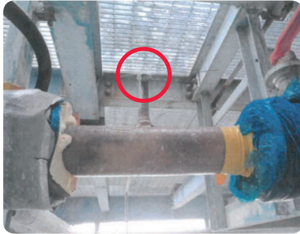
[사고 발생 회수탑 배관 노즐]
