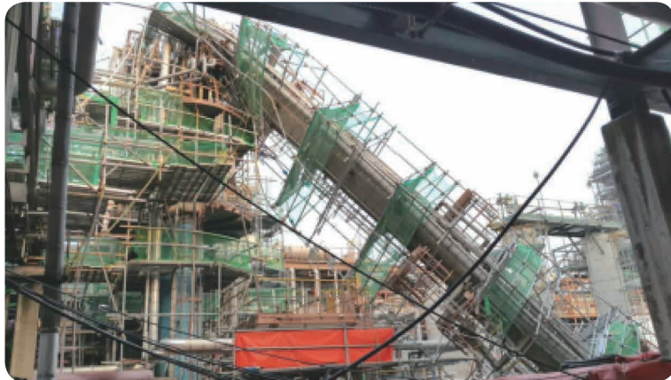
[ 내부화재로 꺾여 손상된 Column ]
