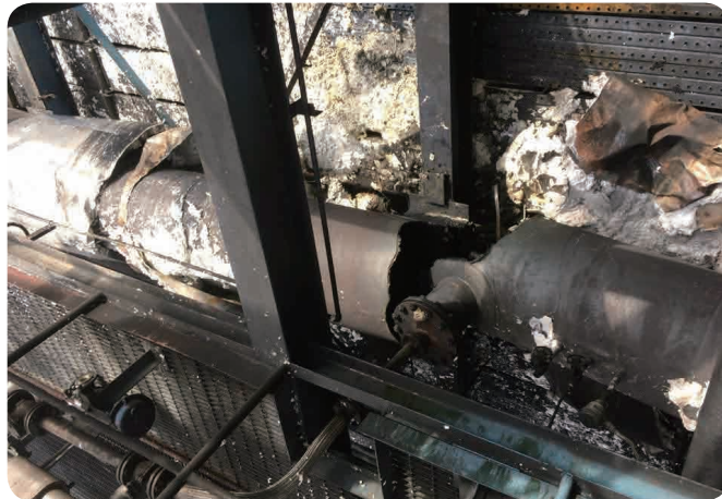
[화재로 파손된 배관]
