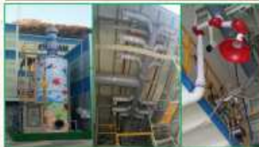
비상배기 (개선 후)
