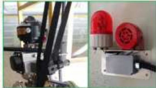
자동 밸브 (개선 후)
