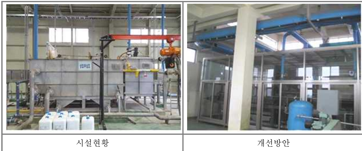
<그림 3-33> 가압부상시설 주변 구획화 및 악취포집설비 개선
